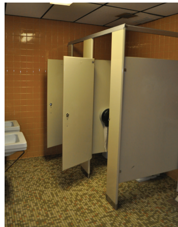
Inaccessible Toilet Stalls
