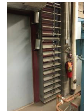
Combustion Air Louver
